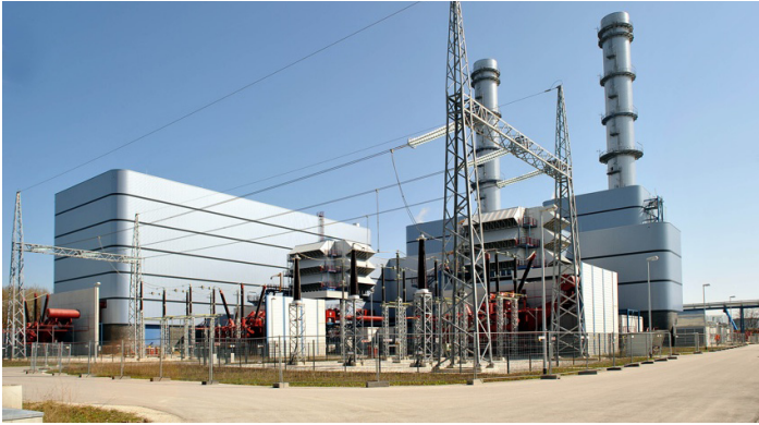
Setzt Maßstäbe hinsichtlich Effizienz, Klimaschutz, Leistungsfähigkeit und Wirtschaftlichkeit: Das Gas- und Dampfturbinenkraftwerk Irsching 5 erreicht einen Wirkungsgrad von knapp 60 Prozent und kann seine Erzeugungsleistung von 860 Megawatt äußerst flexibel einsetzen.
