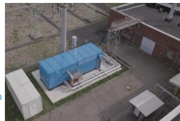
Erstinstallation Aurelia A400 Erste Zündung 09/2022 Huntorf, Deutschland
