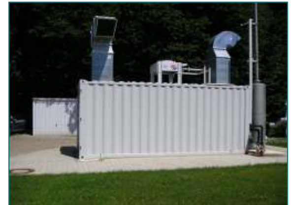
Kläranlage Wittlage, Bad Essen
